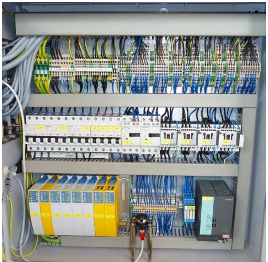
Der Schaltschrank ist voll belegt.
