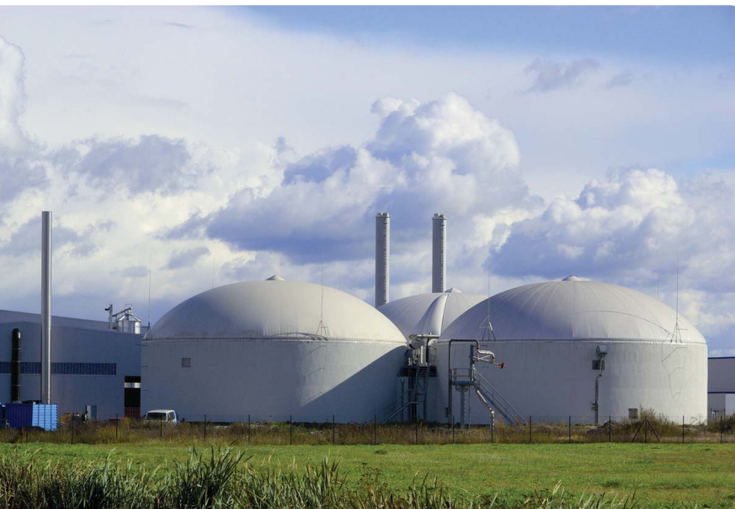
Bild 4: Die moderne Steuerungstechnik von Sigmatek kommt bei zahlreichen Biogasanlagen zum Einsatz. Mit dieser niederländischen Anlage werden täglich 30 Megawatt Strom produziert. Damit wird die Versorgung von rund 3.000 Haushalten sichergestellt.
